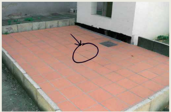
Ein Fehler bei der Herstellung der äußeren Entwässerungsschicht (Gefälleestrich) hatte eine muldenartige Vertiefung zur Folge. Diese hat zwar zu einer etwas stärkeren Neigung zur Verschmutzung, aber nicht zu einem Schaden geführt.
